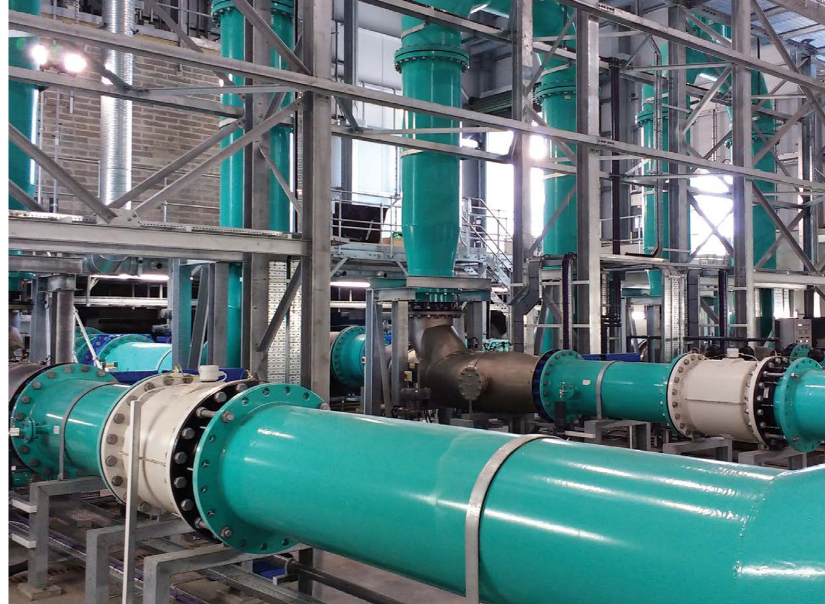
UVLX-30800-30 système d'amalgame basse pression installé dans une usine d'eau potable au Royaume-Uni
